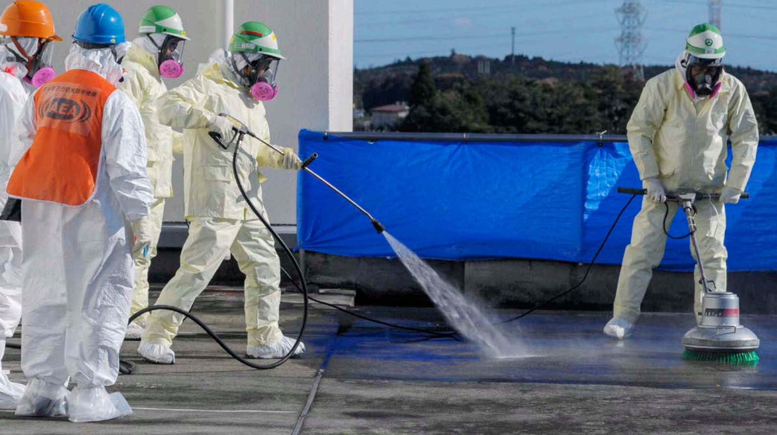
Dekontamination des Gebäudes der Gemeindeverwaltung in der japanischen Stadt Okuma im Dezember 2011
