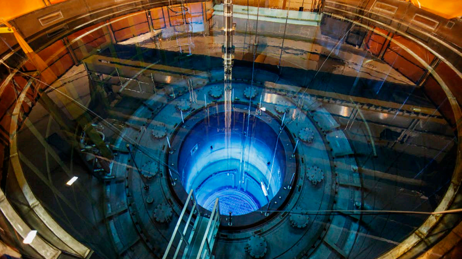
Der offene Reaktor des KKW Mühleberg während einer Inspektion
