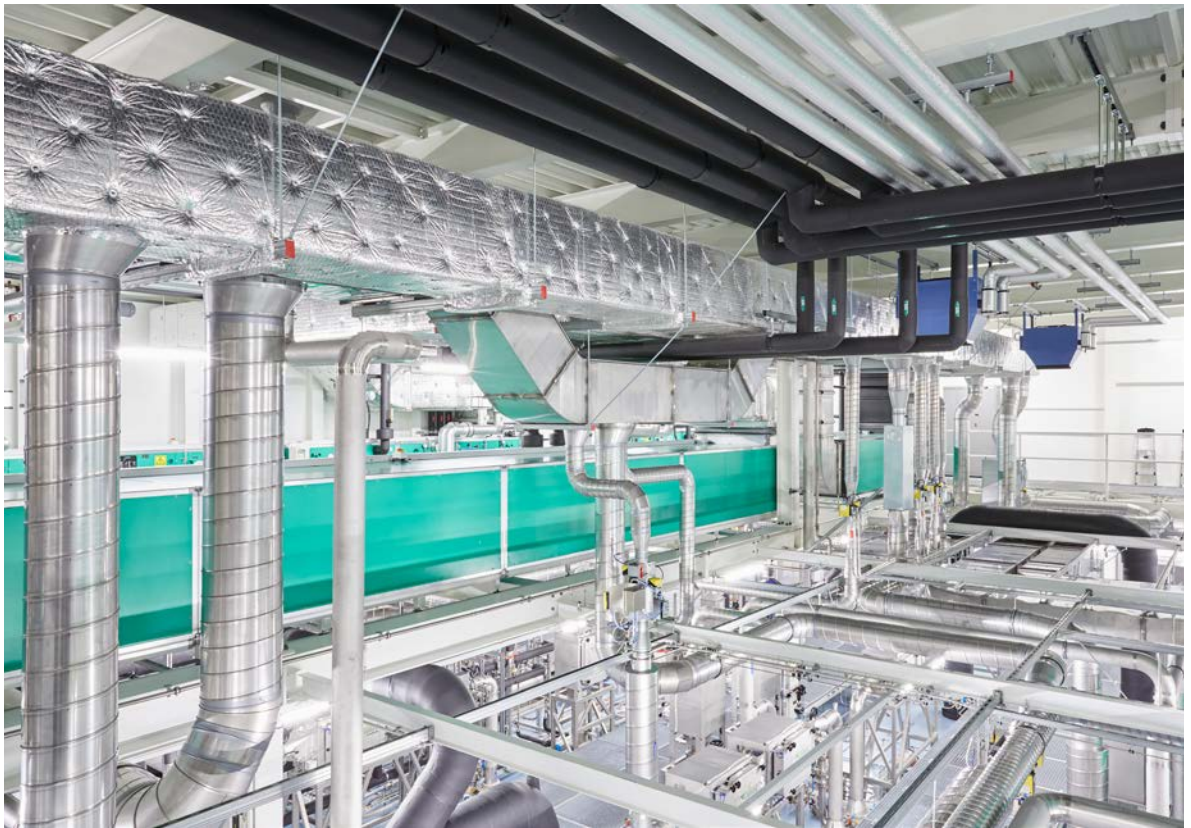
Installation de ventilation du laboratoire de sécurité biologique.
